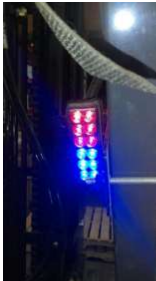
Ilustración 24. Luz indicadora de proximidad de montacargas.
