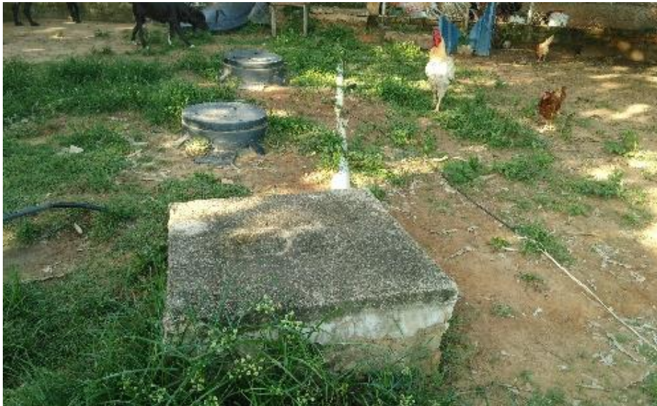
Figura 37. Sistema de tratamiento de aguas residuales (PTAR familiar).
